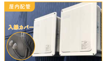
屋内配管 入線カバー パワーコンディショナへの配管・配線が壁内を通ります。
